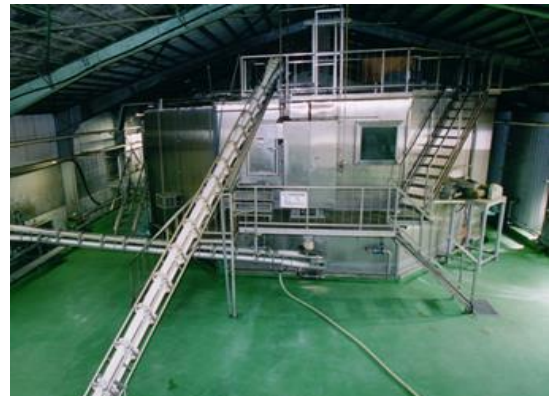
自動製麹装置 12 t × 2 基
